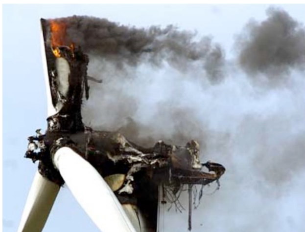
Incendie de la nacelle d'une éolienne le 14 janvier 2016 lors de travaux d'entretien à Uedem, en Belgique
