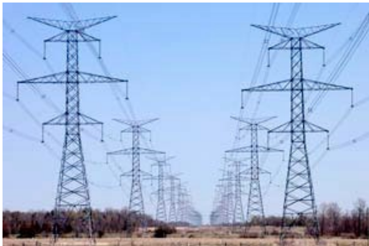
Lignes à haute tension nécessaires à l'interconnexion des réseaux européens
