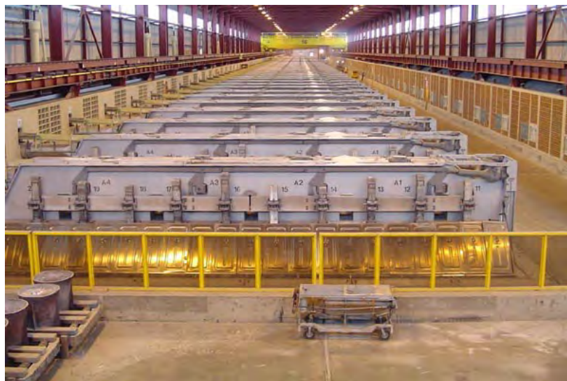
Une salle des cuves d'électrolyse au Québec (Alouette Inc.)
